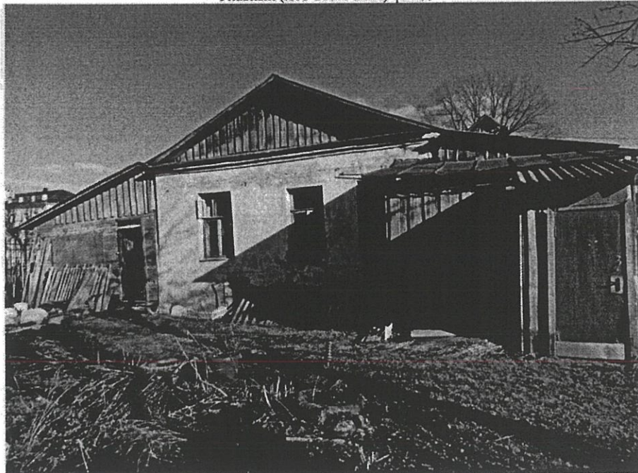
«Дом жилой Акатова, 1-я пол. XIX в.» г. Кострома, ул. Комсомольская, 31 Дворовый (северо-западный) фасад
